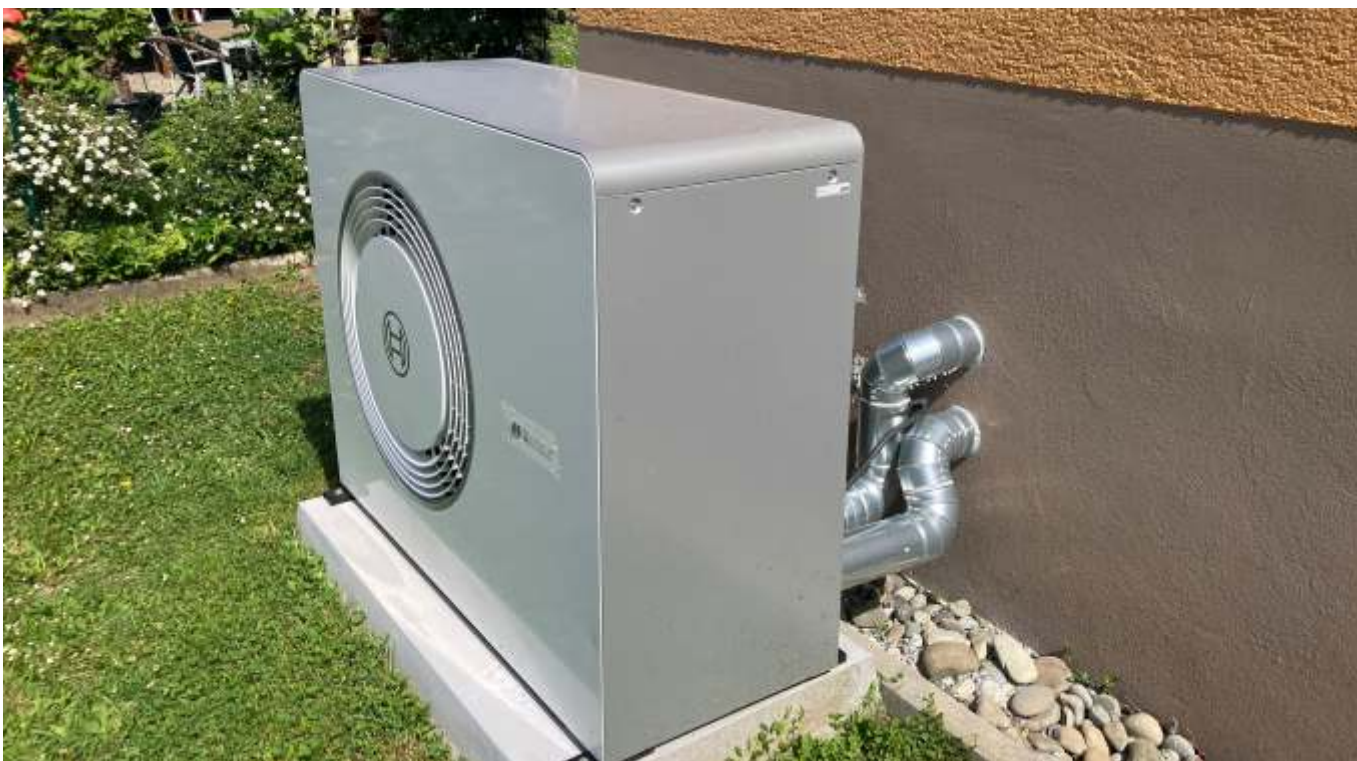
Die Luft-Wasser-Wärmepumpe in der Austraße 71/73
