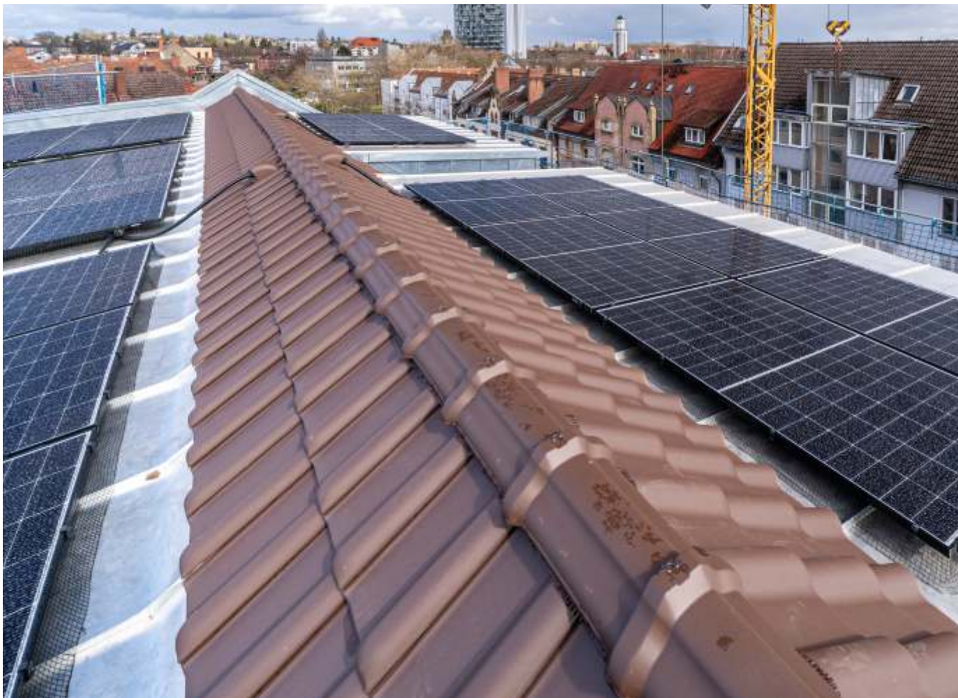
Photovoltaik auf dem neuen Dach Petershauser Str. 5
